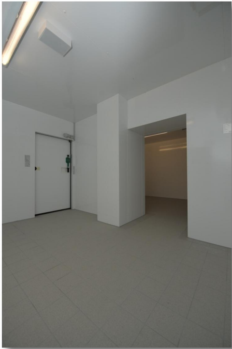
KÜHLRAUM-TUNNEL DURCH BRANDSCHUTZWAND
