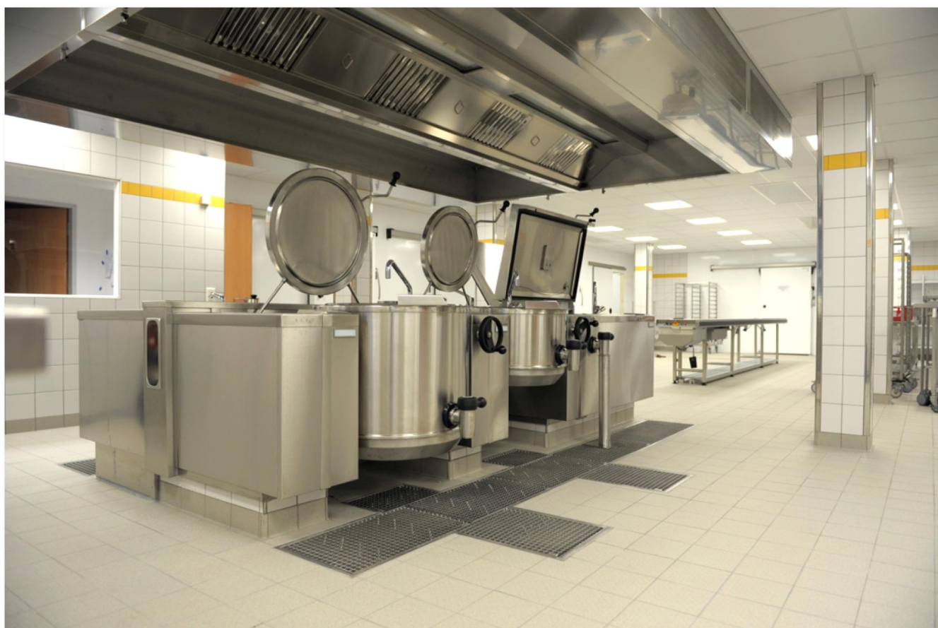
KOCHBLOCK MIT LÜFTUNGSHAUBE
